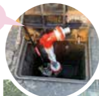
スタンドパイプ
